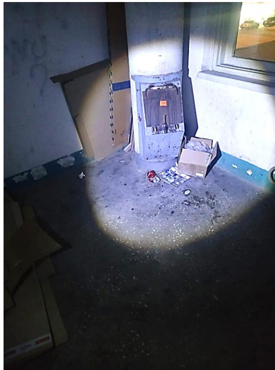
Фото № 3. Вид мусоропровода, расположенного на этаже, по адресу: ***
